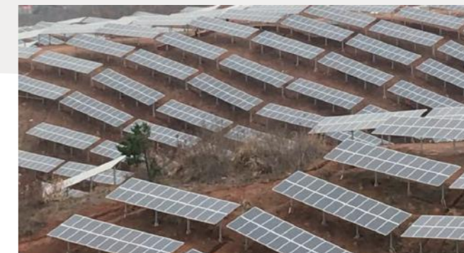
贵州 晴隆 90MW 地面电站 2021年 单玻445W
