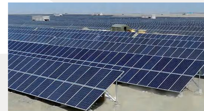
青海 格尔木 20MW 地面电站 2018年 单玻275W
